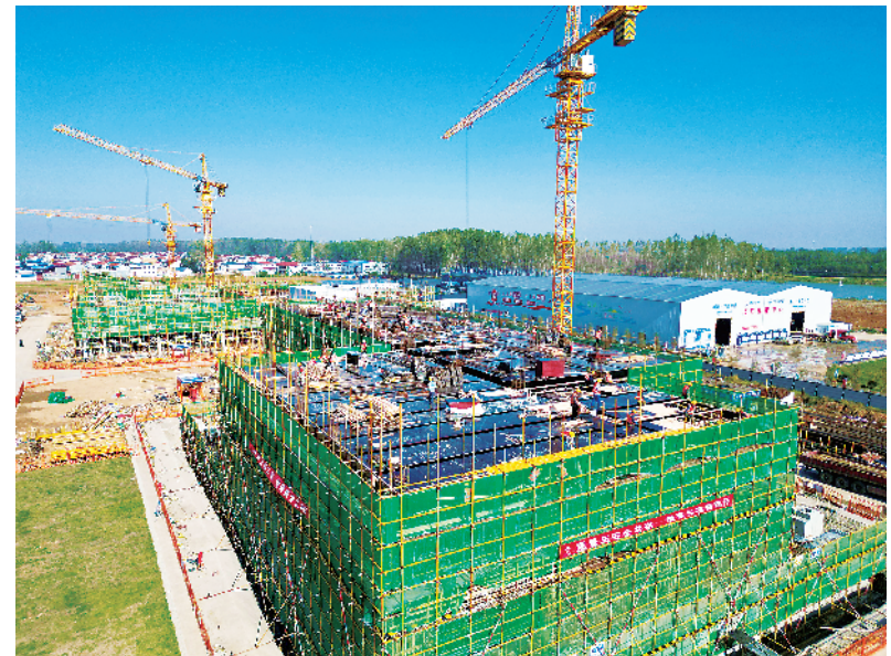
10月24日,周口港中心作业区内,工人们正紧张建设河南交投周口港智能调度中心。在建的河南交投周口港智能调度中心总建筑面积20958平方米,今年6月份动工,预计2025年7月份全部建成。 记者 梁照曾 摄
