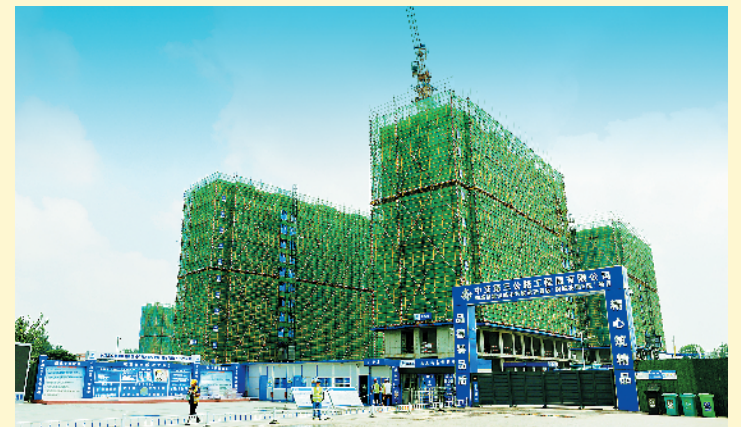
8月7日,记者在郸城县新城中村村改造安置区项目建设现场看到,工程建设者紧锣密鼓、加班加点,加快推进项目建设,确保征迁群众如期住上新房。记者徐松摄
